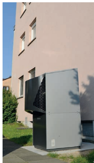
Neue Energie: Wärmepumpe am Haus Friedensstraße 25a
